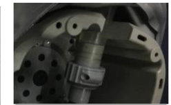
PE air pipe loose
